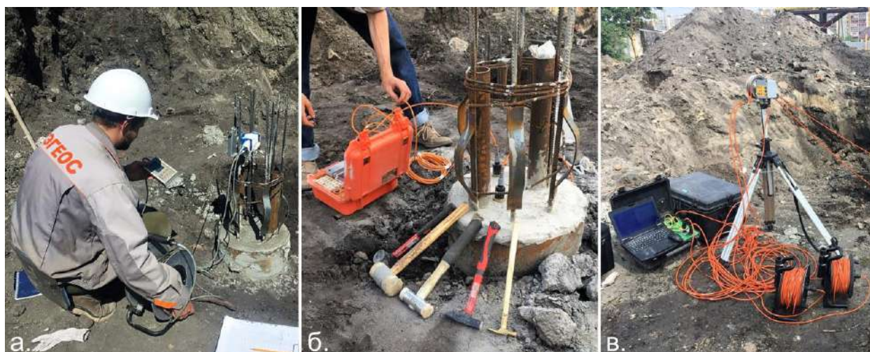
Рисунок 1. Полевые испытания сплошности опытных буронабивных свай на объекте строительства в г. Саратове с применением неразрушающих геофизических методов: а – термометрического, б – сейсмоакустического, в – ультразвукового.
